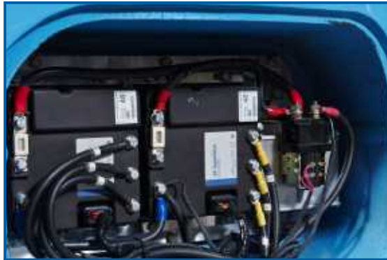
Die DANAHER AC-Controller sind im Heck angebracht und über ein CAN-BUS-System miteinander verbunden.
